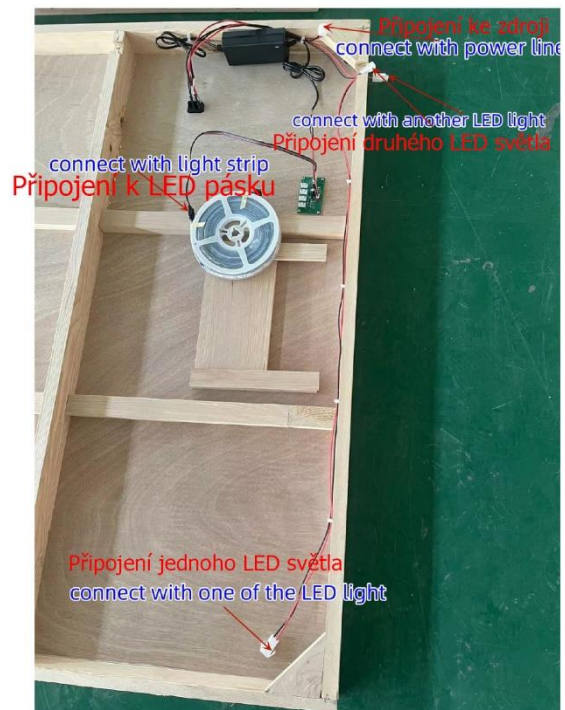
Připojení umístěné ve stropním panelu
