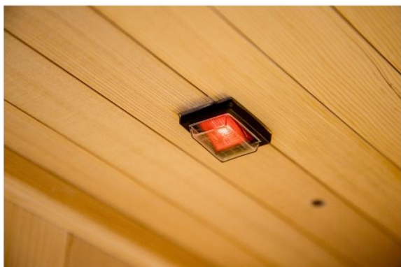
Vypínač rohového osvětlení
